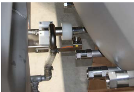
Système de lavage automatique. Sistema de lavado automatico.
