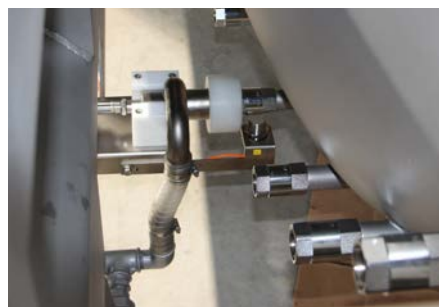
Sistema di lavaggio automatico. Automatic washing system.
