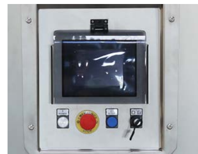
Quadro di comando con PLC. Control panel and PLC.
